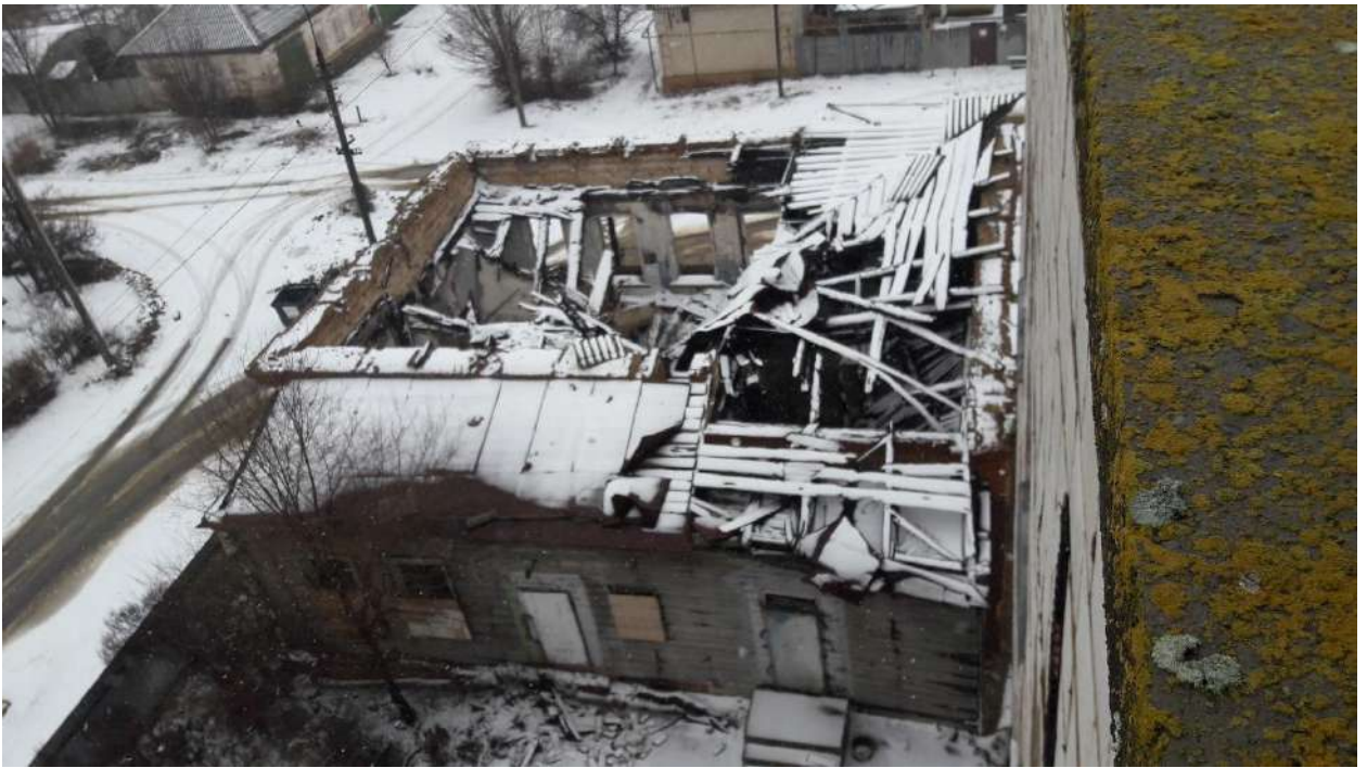
Фото 15. Вид на разрушенную крышу здания по ул. Октябрьская, 17а и перекресток улиц Октябрьская и Гагарина с крыши Дубовской ЦРБ
