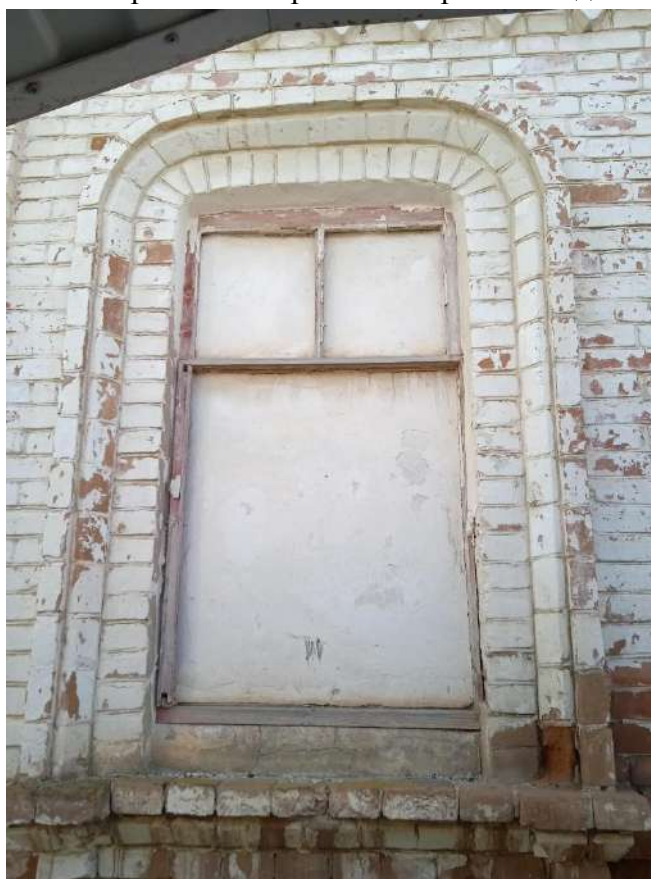
Фото 12. Здание по ул. Буденного, 51. Заложенное окно с остатками деревянной рамы на северо-восточном фасаде
