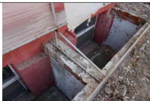
Фото 22. Волгоградская область, г. Волгоград, Ворошиловский район, ул. Пугачевская, 3. Пряжки. Разрушение штукатурного слоя. Износ покрытия
