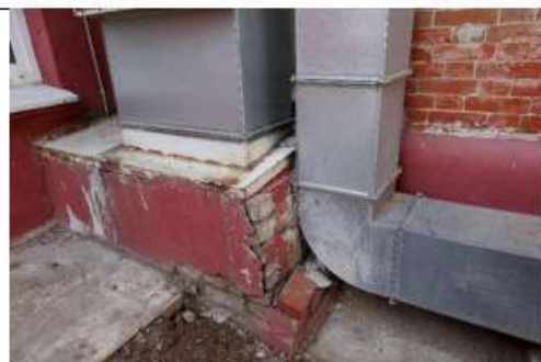
Фото 11. Волгоградская область, г. Волгоград, Ворошиловский район, ул. Пугачевская, 3. Прямок. Разрушение штукатурного слоя.
