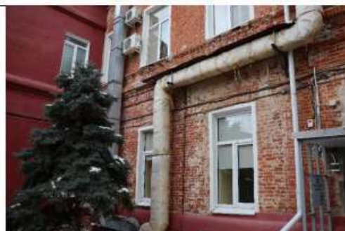
Фото 12. Волгоградская область, г. Волгоград, Ворошиловский район, ул. Пугачевская, 3. Примыкание пристройки.
