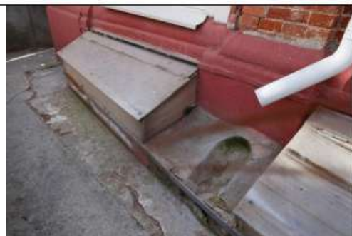
Фото 19. Волгоградская область, г. Волгоград, Ворошиловский район, ул. Пугачевская, 3. Пряжки, отмостка.
