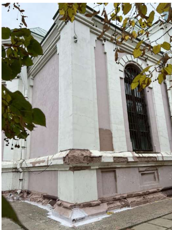
Фото №4. Западный угол здания, разрушения штукатурного слоя.
