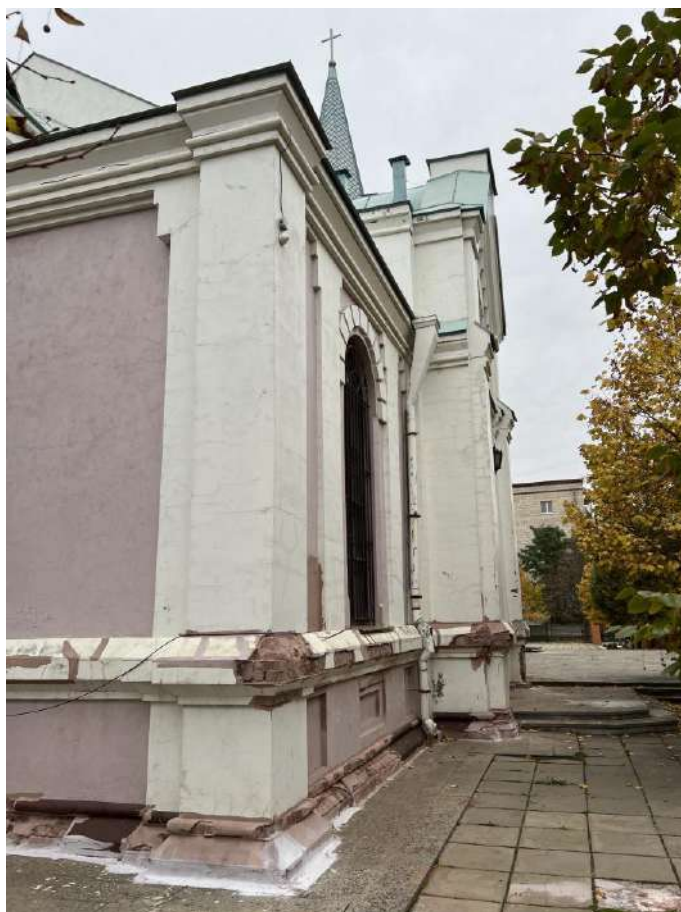
Фото №5. Северный угол здания, разрушения штукатурного слоя.
