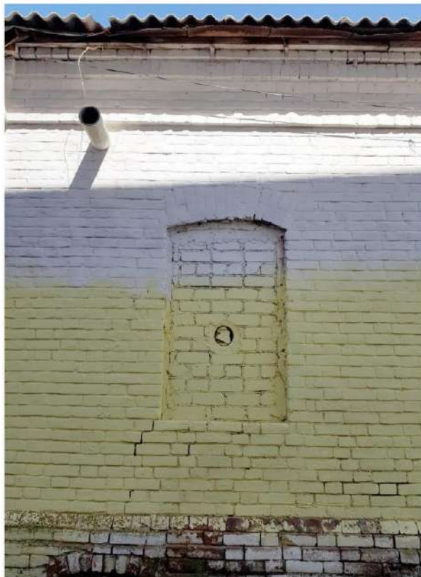
Ф. 16. Фрагмент юго-восточного фасада, заложенный оконный проем.
