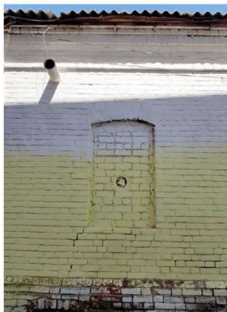
Ф. 16. Фрагмент юго-восточного фасада, заложенный оконный проем.
