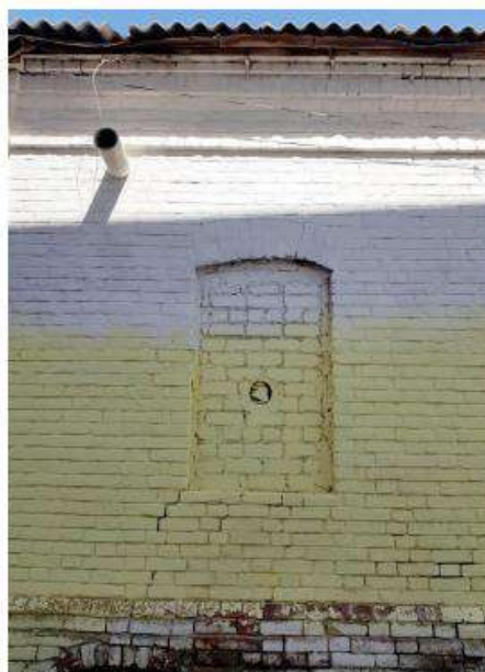
Ф. 16. Фрагмент юго-восточного фасада, заложенный оконный проем.
