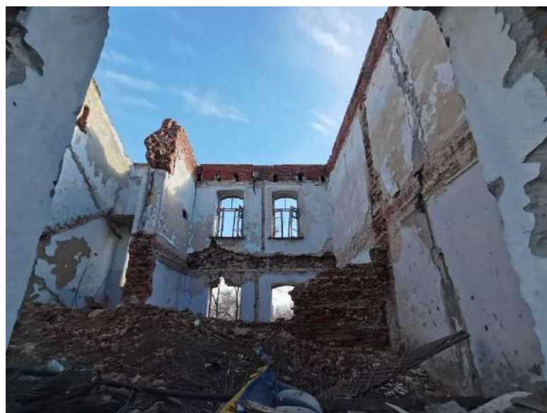
Руинированное состояние интерьера: утрачены лестничные марши, перекрытия, крыша.
