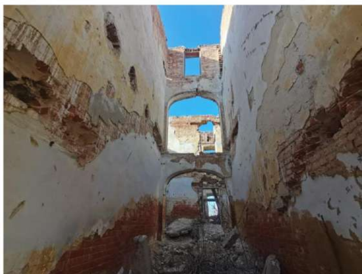
Т.17 Руинированное состояние интерьера
