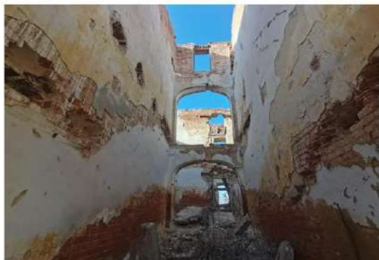
Т.17 Руинированное состояние интерьера
